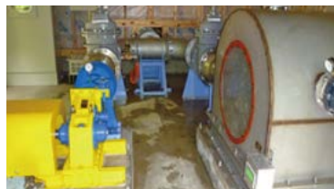
写真：白糸の滝ふれあいの里に設置した発電設備 クロスフロー水車+可変速三相同期発電機（左 5kW）と ペルトン水車+アウトローター発電機（右 10kW）
